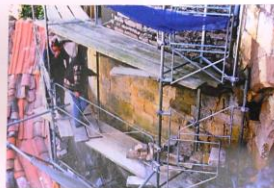
SI - CORDES Panneaux d'élévation Angle recouvert Sud de la tour vers le passage Reprise du parement extérieur
