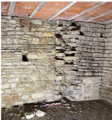
Fig. Jonction M131c(gauche) contre M131b (=M132) près de l'angle (droite) en haut du niv. -1a. À droite la tourelle et son ouv172 (de tir) bouchée. Crédit F. Guillot
