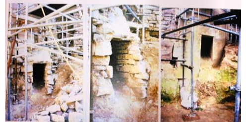
SI - CORDES Panneaux d'élévation Élévation Nord Dépouillage et installation de la sautoie de béton sur le socle existant
