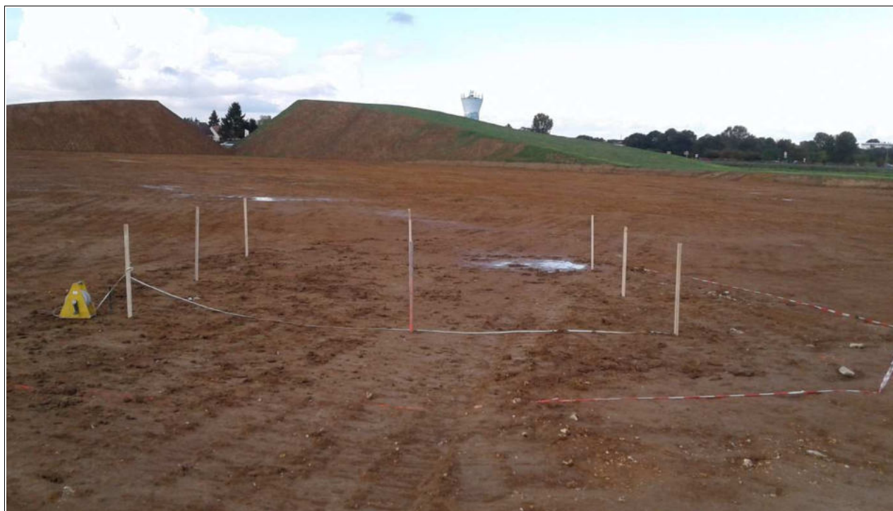
Photographie de l'anomalie le 18 septembre 2017 prise par notre BE
