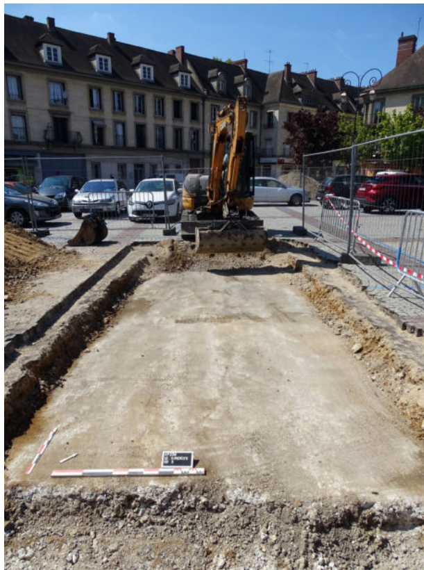
Figure 48 - Sondage 3 - La dalle de béton mise au jour sur une grande partie de la surface sondée
