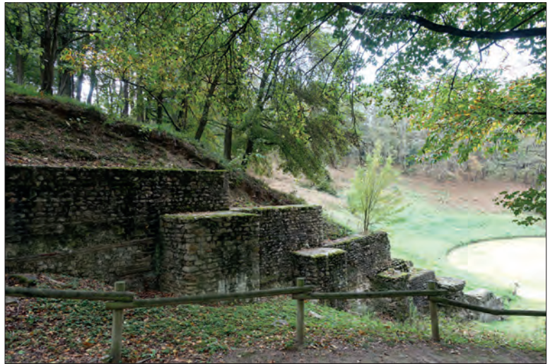
Fig. VII.2-22 - Le murs à contreforts de l'amphithéâtre avec l'arène en contrebas © Cliché SIG L. Déodat 2022.
