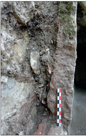
Fig. VII.4-41 - Détail de la terre infiltrée entre le piedroit sud et l'enduit hydraulique, UE 100027 © Cliché L. Déodat 2022.
