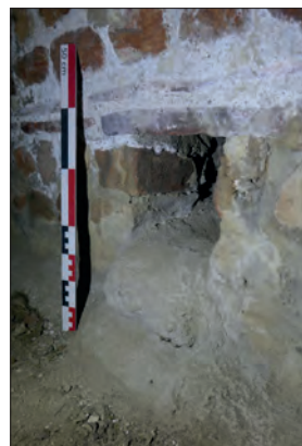
Fig. VII.3-54 - Détail d'une des petites ouvertures dans la conduite inférieure © Cliché A. Remy, octobre 2021.
