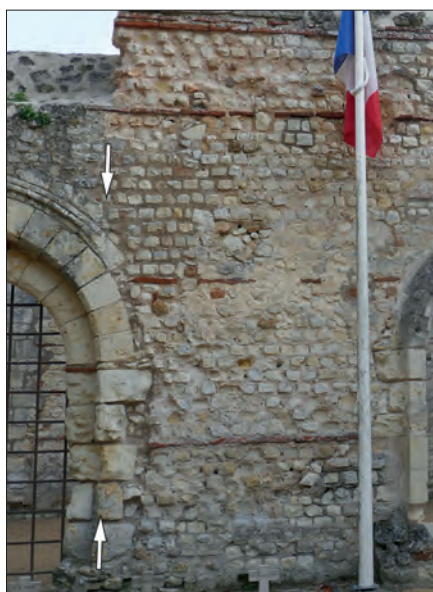
Fig. VIII.4.15 - traces de l'ancien collage du mur perpendiculaire à la façade sud © Cliché A. Remy.
