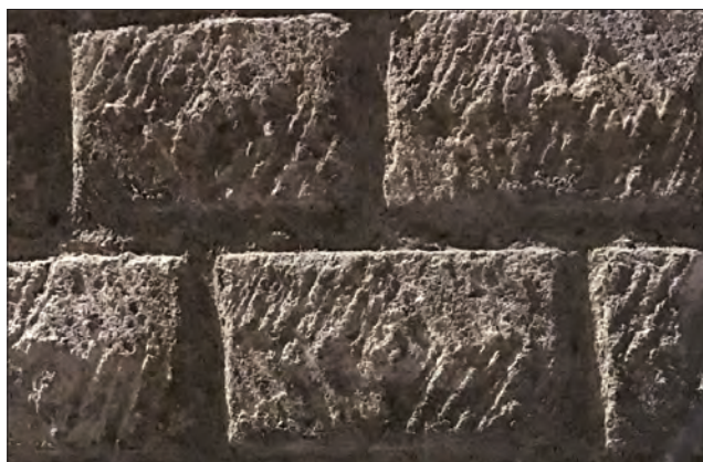
Fig. VII.3-77 - Moellons d'un mur des thermes de Cluny, Paris. Détail des traces de taille © d'après Meunier et Monteil 2020, p. 201 : fig. 4-55 - image C.
