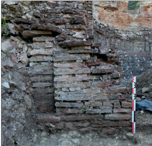
Fig. VII.3-36 - Vue depuis le nord-ouest de la façade occidentale du massif d'angle nord de l'abside 1002 © Cliché X. Favreau, juillet 2022.
