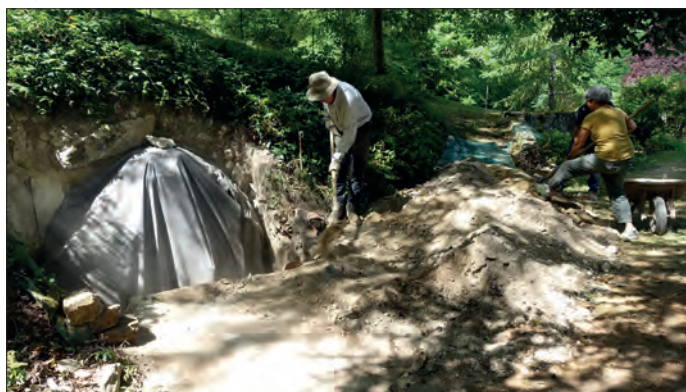
Fig. VII.4-44 - L'aqueduc en cours de recouvrement avec pose d'un géotextile de protection, M. Cousin et C Coiffard à l'œuvre © Cliché L. Déodat 2022.
