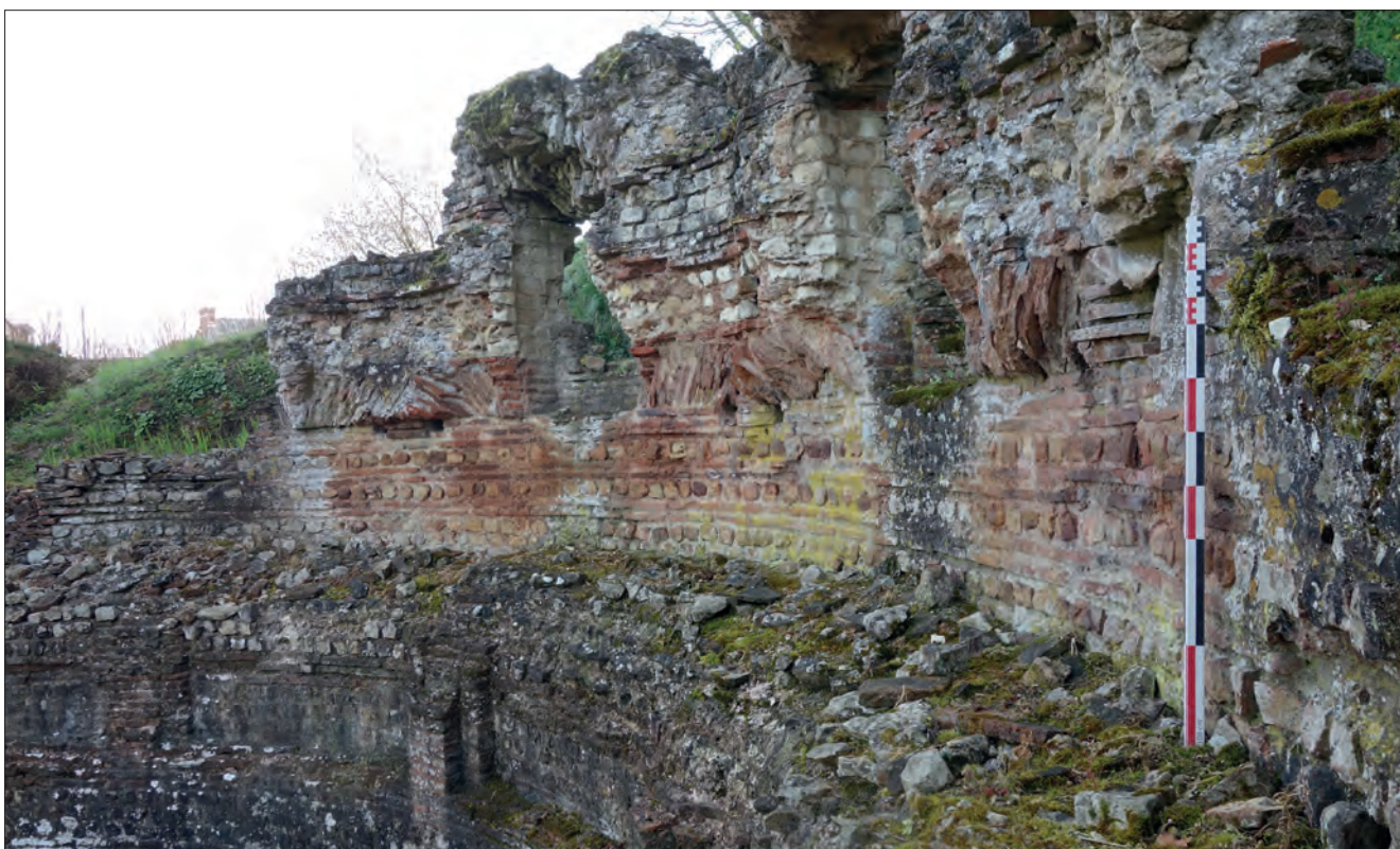
Fig. VII.3-13 - Vue depuis le sud du parement conservé de la conduite supérieure, surmonté par le registre supérieur de l'élévation de l'abside 1002 © Cliché X. Favreau, mars 2021.
