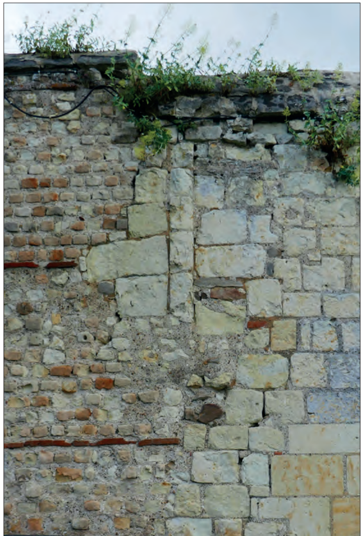
Fig. VIII.4.25 - Détail du vestige de piédroit 30042 en partie haute du mur nord de la nef © Cliché A. Remy.
