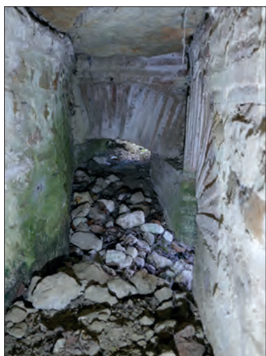
Fig. VII.3-51 - Illustration de l'encombrement de la conduite inférieure au niveau de ses ouvertures au sud © Cliché A. Remy, octobre 2021.
