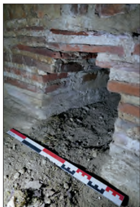
Fig. VII.3-53 - Détail d'une des grandes ouvertures dans la conduite inférieure © Cliché A. Remy, octobre 2021.
