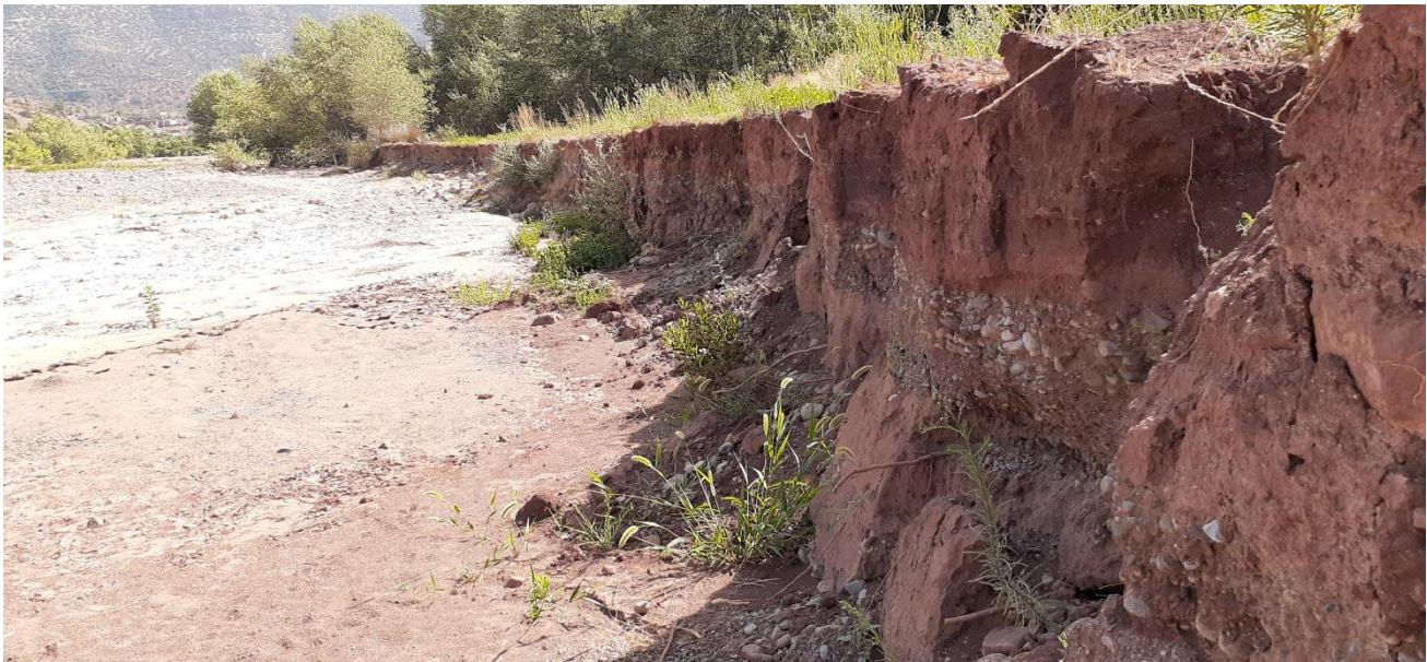
Photo n° 3: Exemple d'une berge sapée
