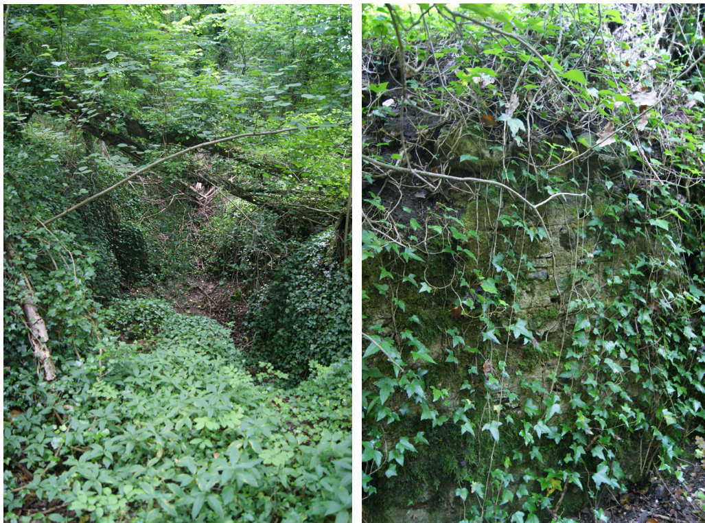
Figure 12 - Etat en 2016 des maçonneries du sanctuaire fouillé dans les années 1910 par L. Coutil et A.-G. Poulain (à gauche : pièce excavée non rebouchée à l'issue des fouilles ; à droite : détail de joints tirés au fer)
