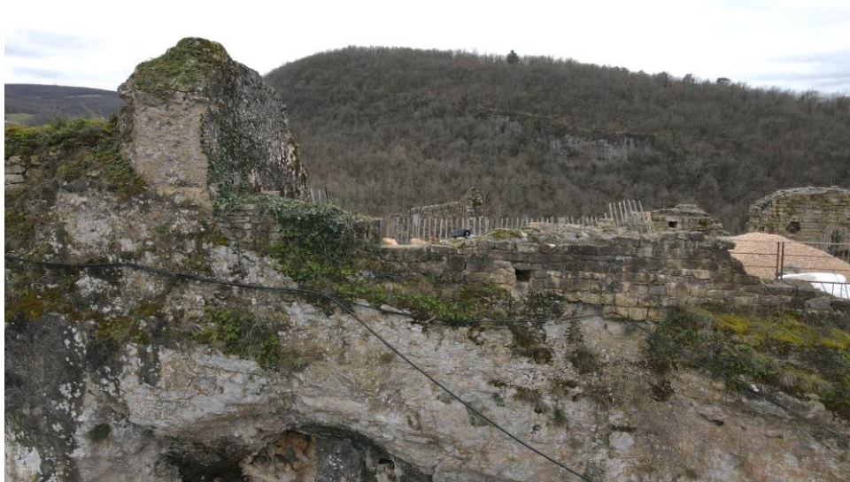
Fig. Point 5. Aspect de l'enceinte : amont du logis 3. Notez l'ouverture dans le mur (M99). Crédit F. Guillot
