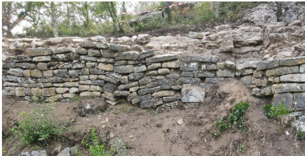
Fig. Parements externes M110, M121 ; dégradation en sous-œuvre dans le M110 (évacuation ?). Crédit F. Guillot
