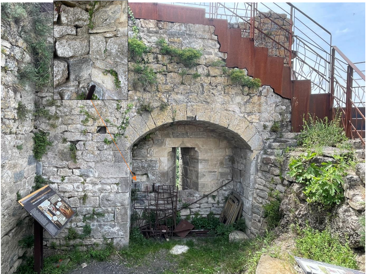
Fig. Parement interne occidental du M35 ; niche de tir et escalier. Crédit F. Guillot.
