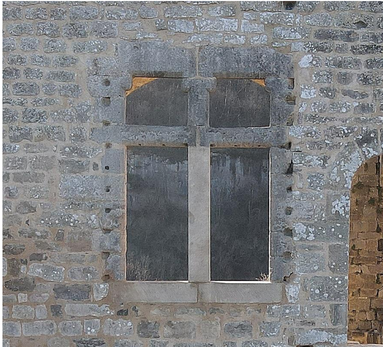
Fig. Parement externe de la fenêtre du premier étage du logis 2. Notez les encoches, y compris sur la traverse. Crédit F. Guillot
