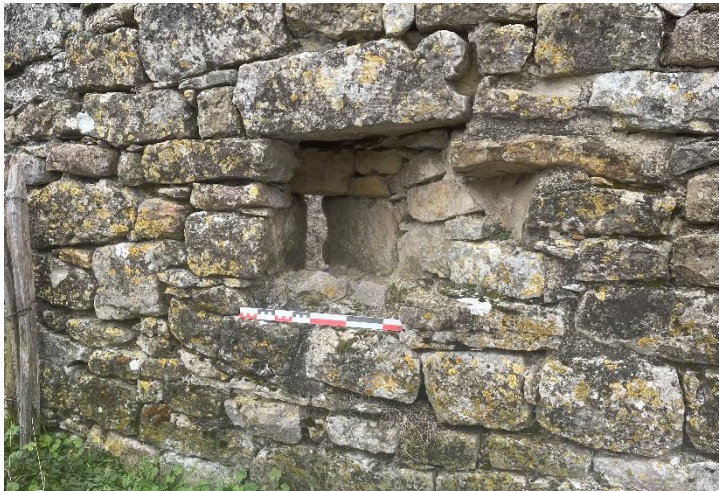
Fig. Interne M3b. Ouverture. Notez le linteau (réemploi d'un décor à colonnette). Crédit F. Guillot
