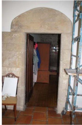
Fig. 14 - Premier étage, mur de refend, porte de la chambre du maître de maison.
