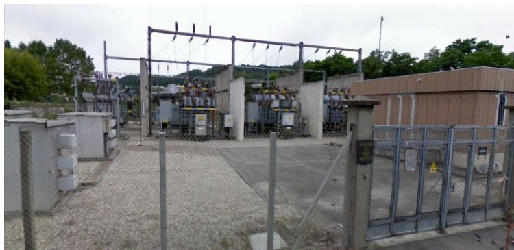
Figure 32 : Transformateur en zone inondable dans le quartier de Vienne Nord Source : Google Street Map
