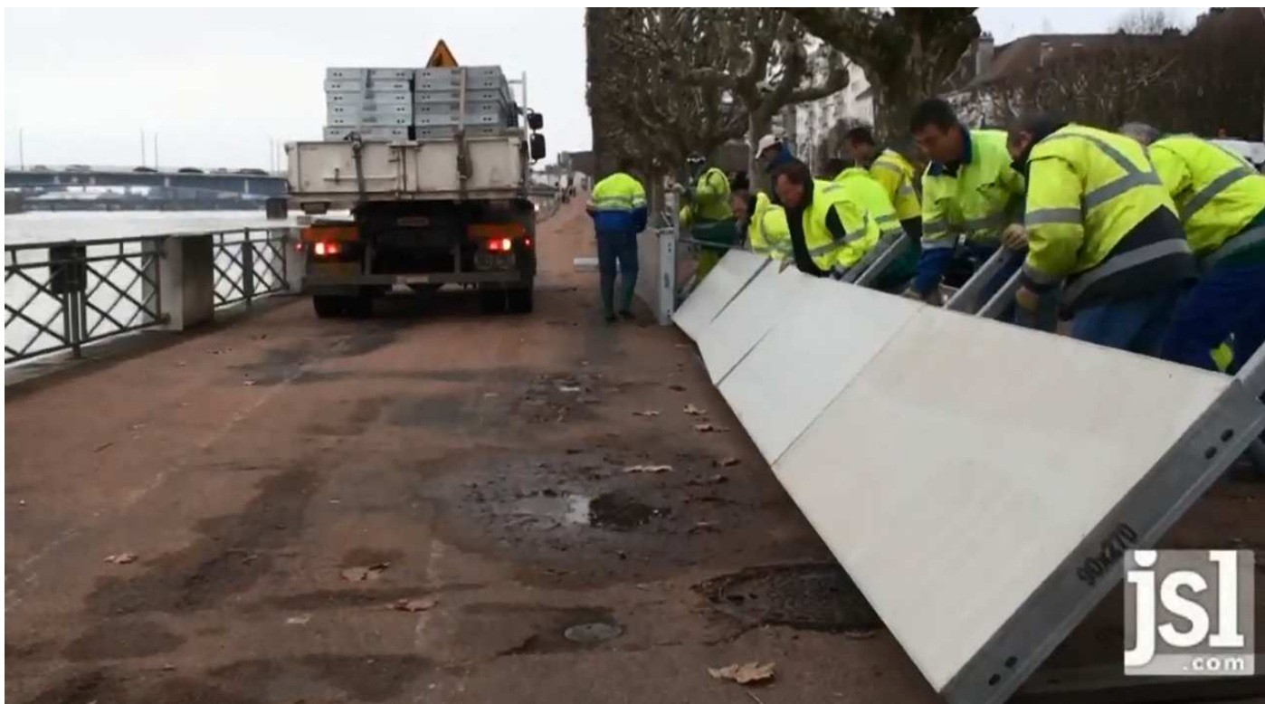
Figure 5 : Digue mobile à Chalon-sur-Saône mise en œuvre en 2010 Source : capture d'écran sur jsl.com
