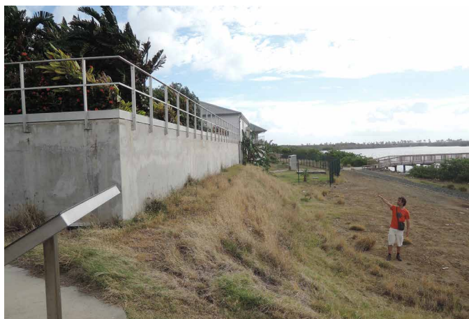
STEP de Quartier d'Orléans rehaussée suite aux conséquences de l'ouragan Irma (Source: EEASM).
