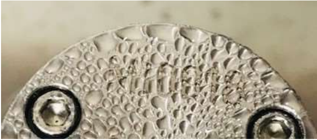
Figure 3 – goutte de condensation à la surface froide d'un corps de pompe.
