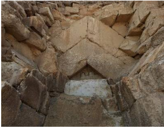
Gros plan sur la zone des chevrons de l'entrée en face Nord.
