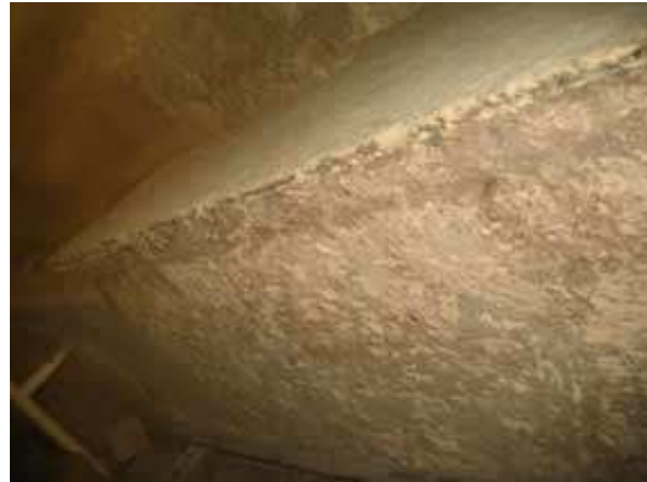
Traces brunâtres sur les banquettes
