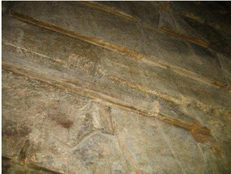
Saignées 3 ème encorbellement sur toute la longueur de la galerie
