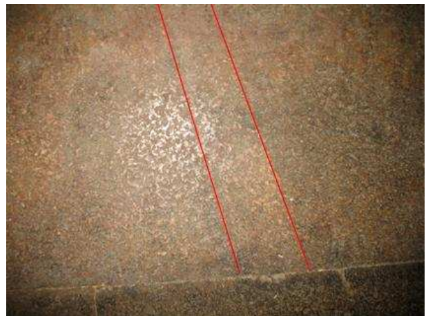
Fissures en partie basse du bloc linteau
