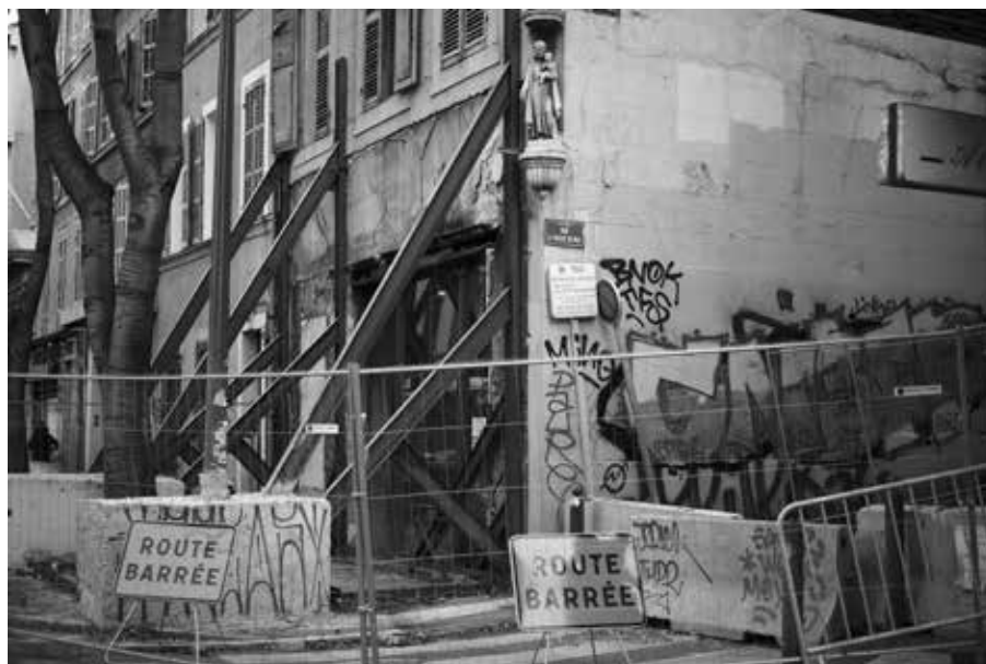
Immeuble placé en péril grave et imminent parmi les 300 depuis le 5 novembre 2018
