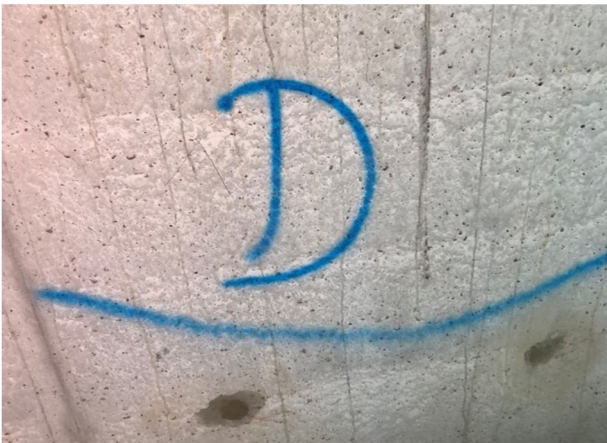
Figure 6. Mur nécessitant un doublage par placo et donc ne requiert pas un travail de finition exposant tel que le ponçage, la perforation, etc.
