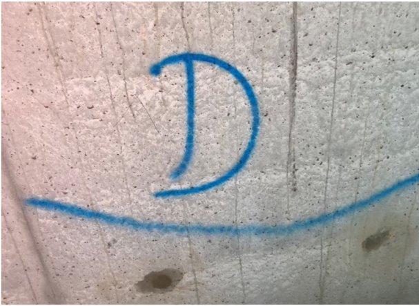
Figure 6. Mur nécessitant un doublage par placo et donc ne requiert pas un travail de finition exposant tel que le ponçage, la perforation, etc.
