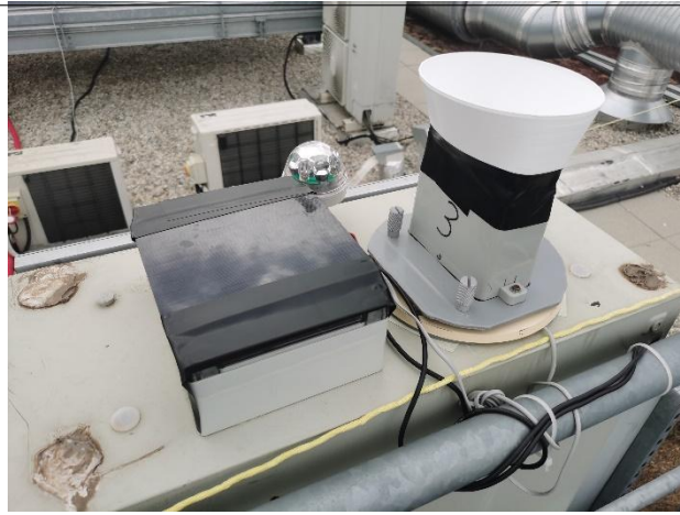
Figure 3. Station de mesure installée sur la plateforme GROOF.
