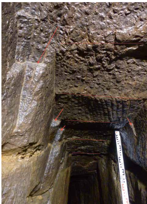
Figure 11 – Traces au plafond des fronts de taille successifs / Spuren am First von aufeinanderfolgenden Ortsbrüsten. Photo © B. Bohly
