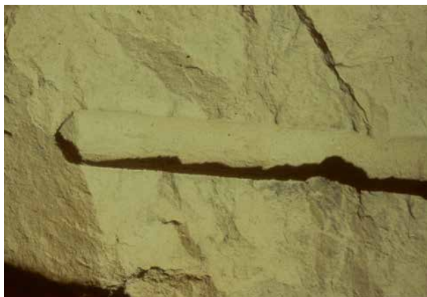
Figure 1 – Trace de fleuret en paroi / Bohrerspür in der Wand.
