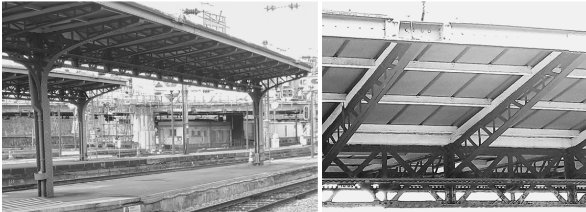
FIGURE 3 – Situation d’origine de la poutre treillis rivetée servant d’objet d’étude : les abris de quais de la Gare de l’Est à Paris. Photos : SNCF / AREP.
