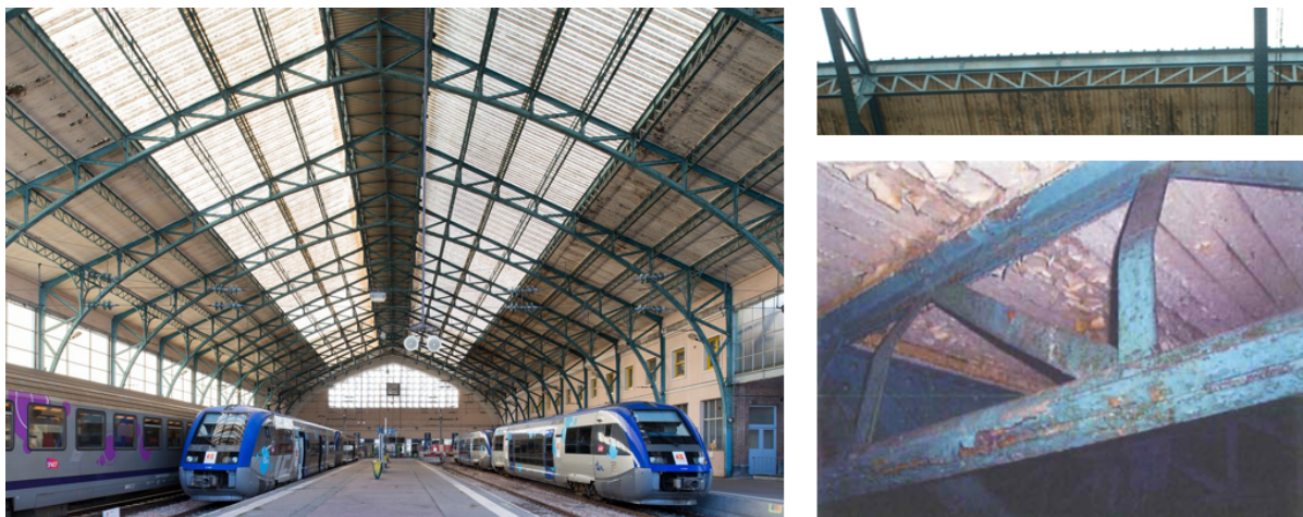
FIGURE 1 – Exemple de halle de gare historique : Le Havre. Vue globale, vue d'une panne et détail d'une panne avec des montants présentant des déformations excessives hors-plan. Photos : SNCF / AREP. Vue globale : Mathieu Lee Vigneau.
