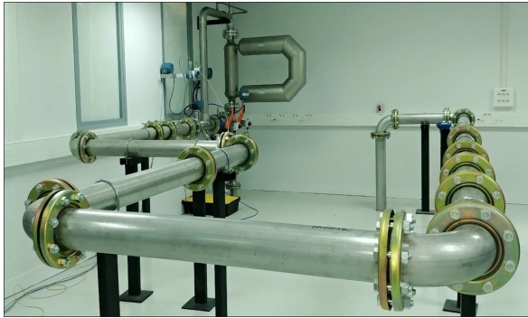
Partie principale : débitmètres de référence et tuyauterie
