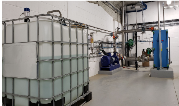
Partie souterraine : cuve d'eau, pompe et échangeur
