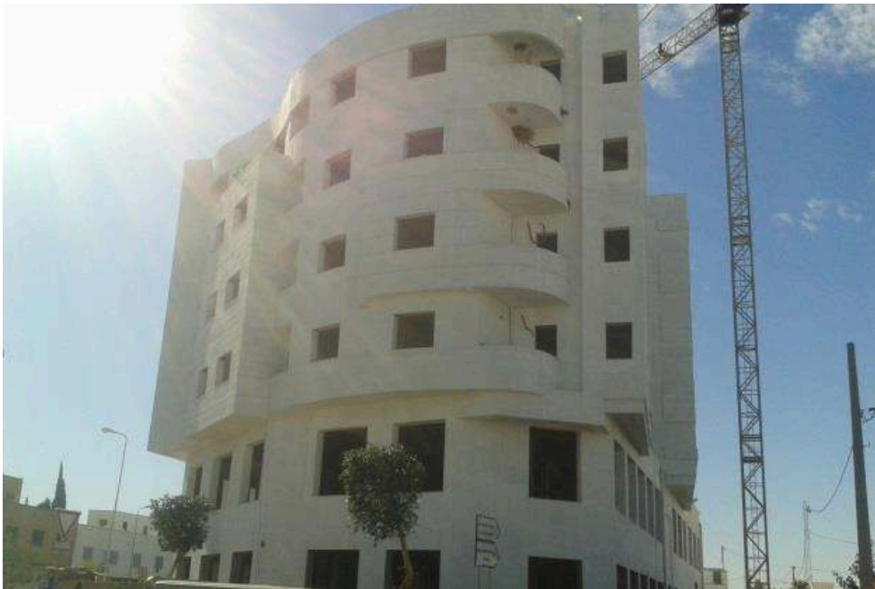
Photo 1 et 2 : Aménagements commerciaux et résidentiels en construction sur la route de Gremda
