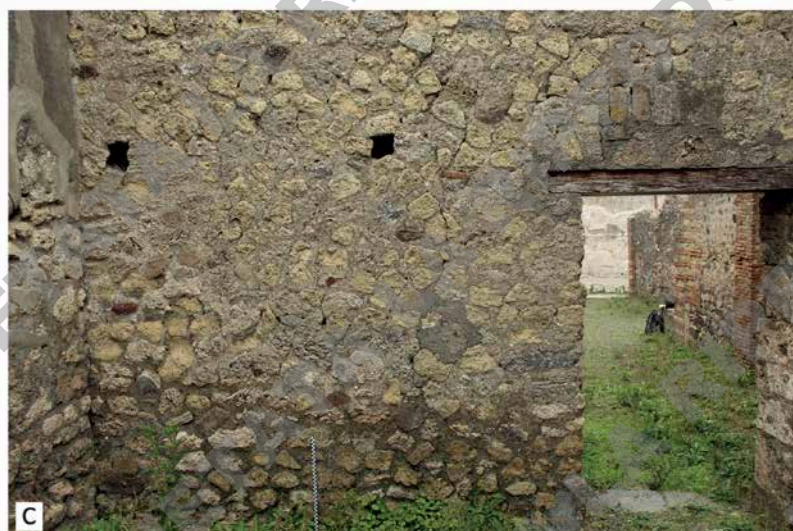
Fig. 87. Alcuni degli elementi strutturali databili al I secolo a.C.: a. Casa di M. Gavio Rufo (VII 2, 16; POM_022), muratura POM_ES_0122, paramento W; b. Casa di M. Gavio Rufo (VII 2, 16; POM_022), muratura POM_ES_0123, paramento W; c. Casa di M. Spurio Am... (VI 7, 15; POM_043), muratura POM_ES_0205, paramento W.
