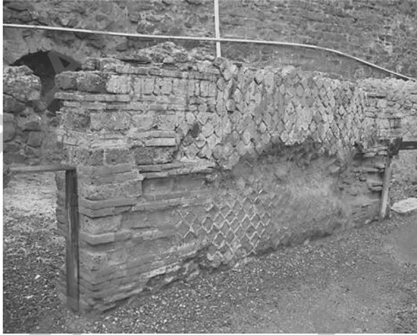
Fig. 78. Muro NW dell'ambiente 5 della Casa di Argo (II, 2) a Ercolano con banda "marcita" e con tipico andamento concavo da distacco del materiale alterato (Cinque, Irollo 2018, 89, fig. 8).
