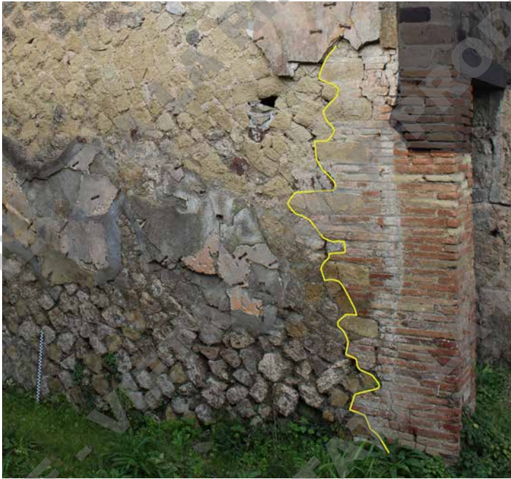
Fig. 71. Muratura POM_ES_0066 con indicazione della parte pre-sismica a destra mentre, a sinistra della linea gialla, si identifica la riparazione. La parte in colore più scuro corrisponde ad un intervento moderno.
