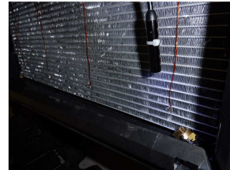
Figure 7 : Dispositif d'aspersion d'eau installé sur le condenseur
