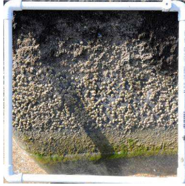
Photo 17 : Balanes sur le pourtour des blocs.
