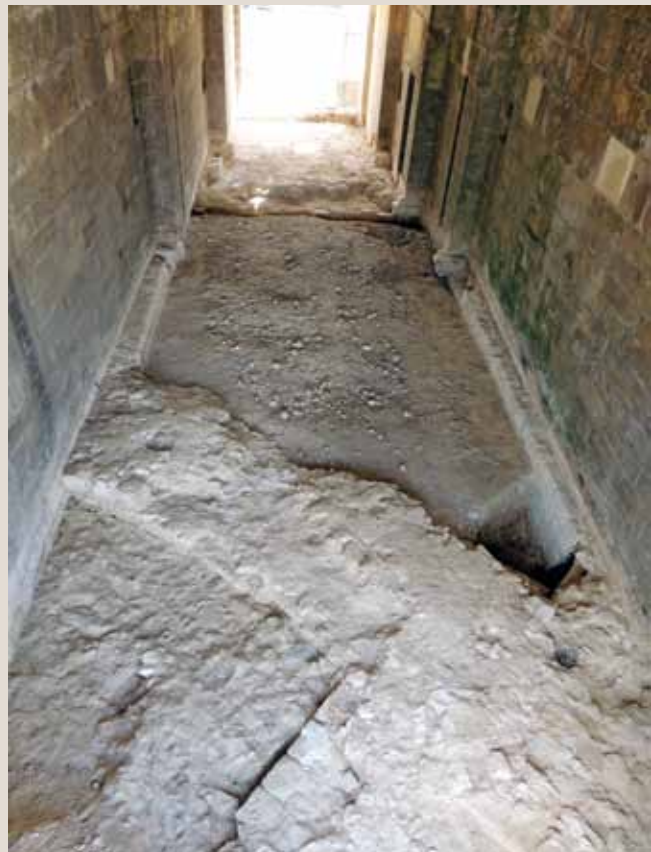
Vue de la tour sud de la porte du boulevard de Louis XI dans la porte François 1 er © SAAM
