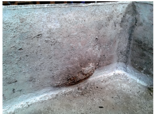
Fig. 10 - Large renforcement au niveau d'une des parois longitudinales qui a entraîné une perforation ainsi qu'une micro fissure (© SAAM & Pierre-Emmanuel GILLET).
