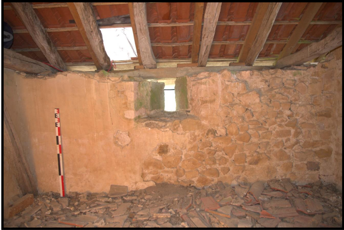
Fig. 57 - Vue du parement intérieur du mur nord de la tour et de sa fenêtre supérieure
