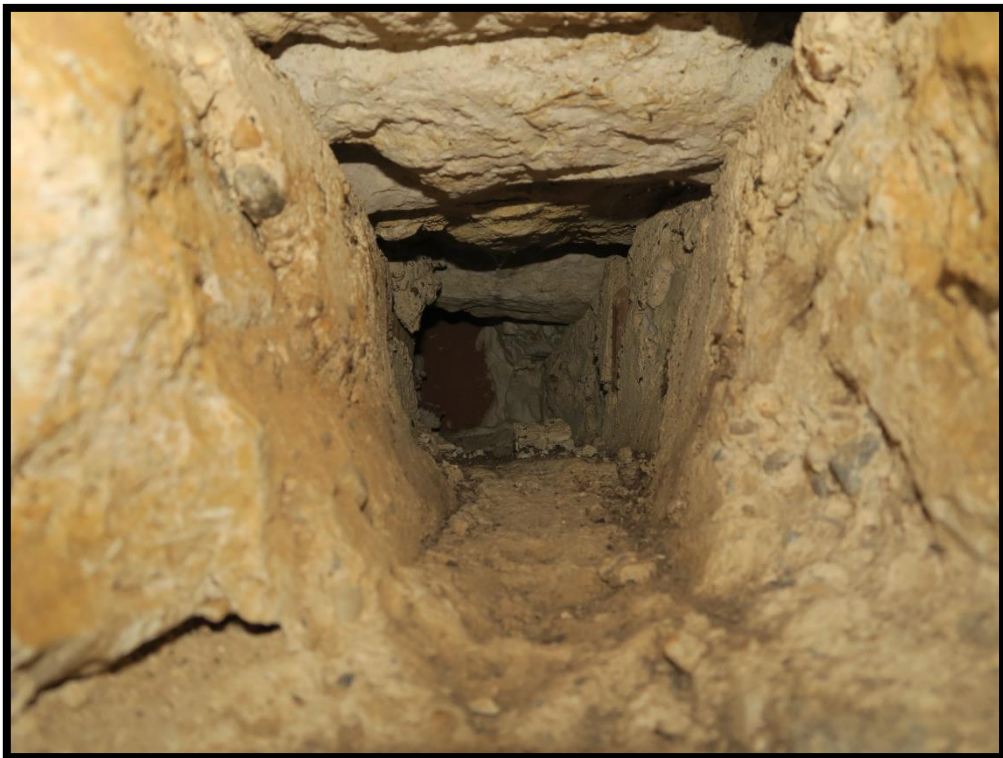
Fig. 45 - Vue de l'intérieur du trou de boulin et du parement intérieur remanié
