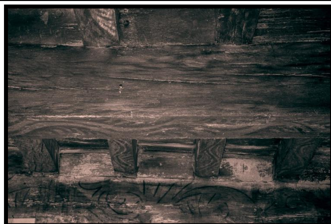
Figure 26 : Vue en infra-rouge des poutres P111a et P1Va
