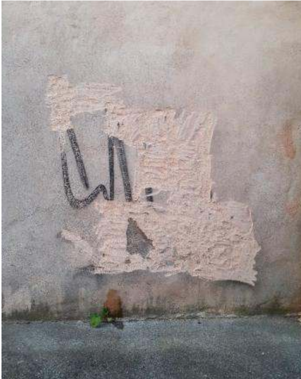
Fig. 5. Exemple d'effacement du graffiti par soustraction de matière
