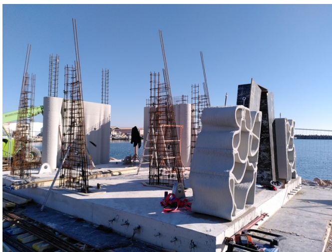
FIGURE 2. Photo de la réalisation d'une structure mixte avec en rouge les poteaux et poutres en béton armé coffrés par les éléments imprimés en 3D (RECIF LAB– 2021)
