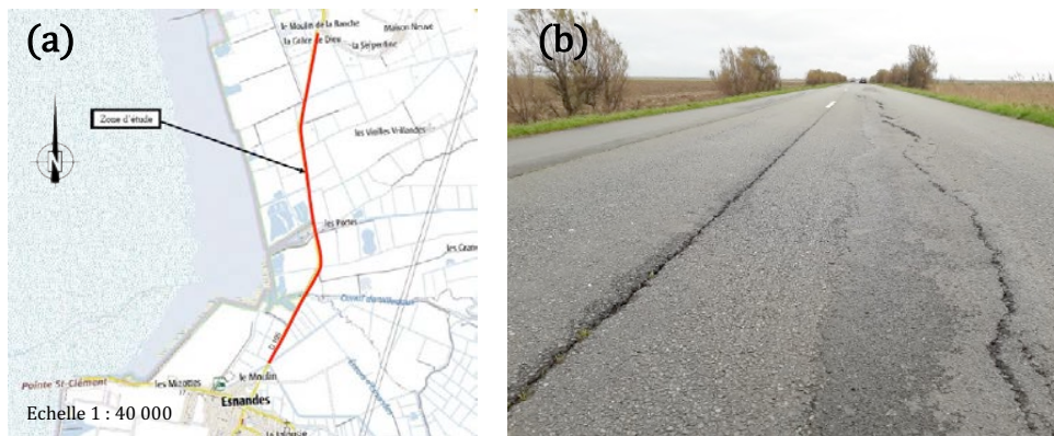
Figure 1. (a) Localisation de la zone d'étude et (b) Exemple d'une fissuration longitudinale observée
