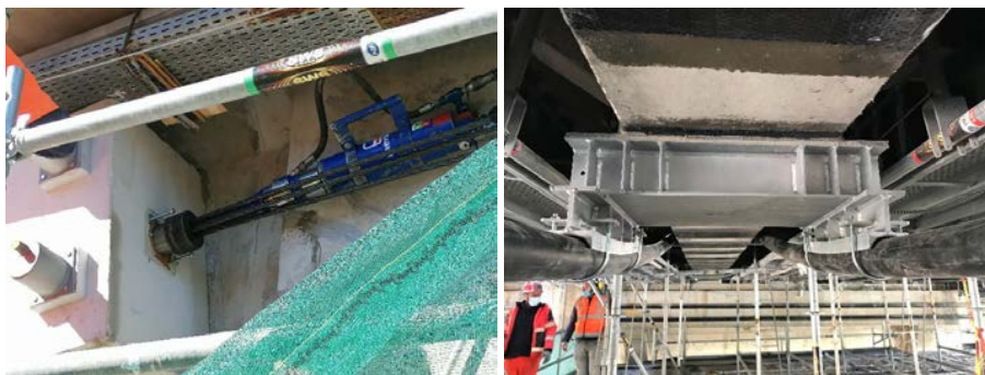
FIGURE 11. Déviateurs métalliques et vérins de mise en tension des câbles de précontraintes
