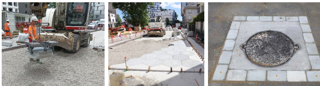
FIGURE 10. De gauche à droite, manutention d'une dalle, démonstrateur en cours de montage, regard de visite entouré de pavés pour faciliter le démontage de la CUD-SF
