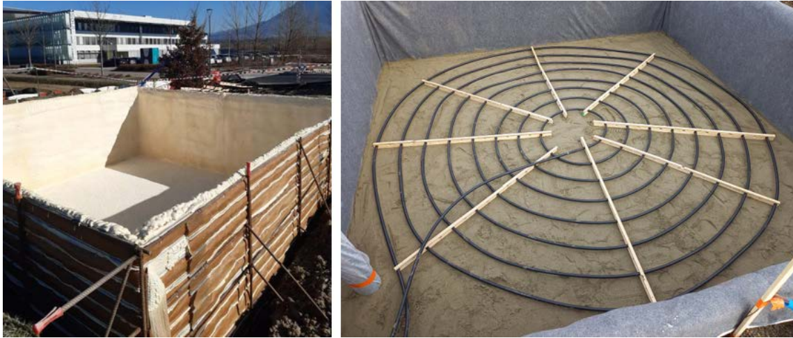
FIGURE 4. Stockage thermique du démonstrateur Dromotherm de Savoie Technolac (à gauche, coffrage métallique et mousse isolante ; à droite, une des spirales d'échange de chaleur avec le stockage)
