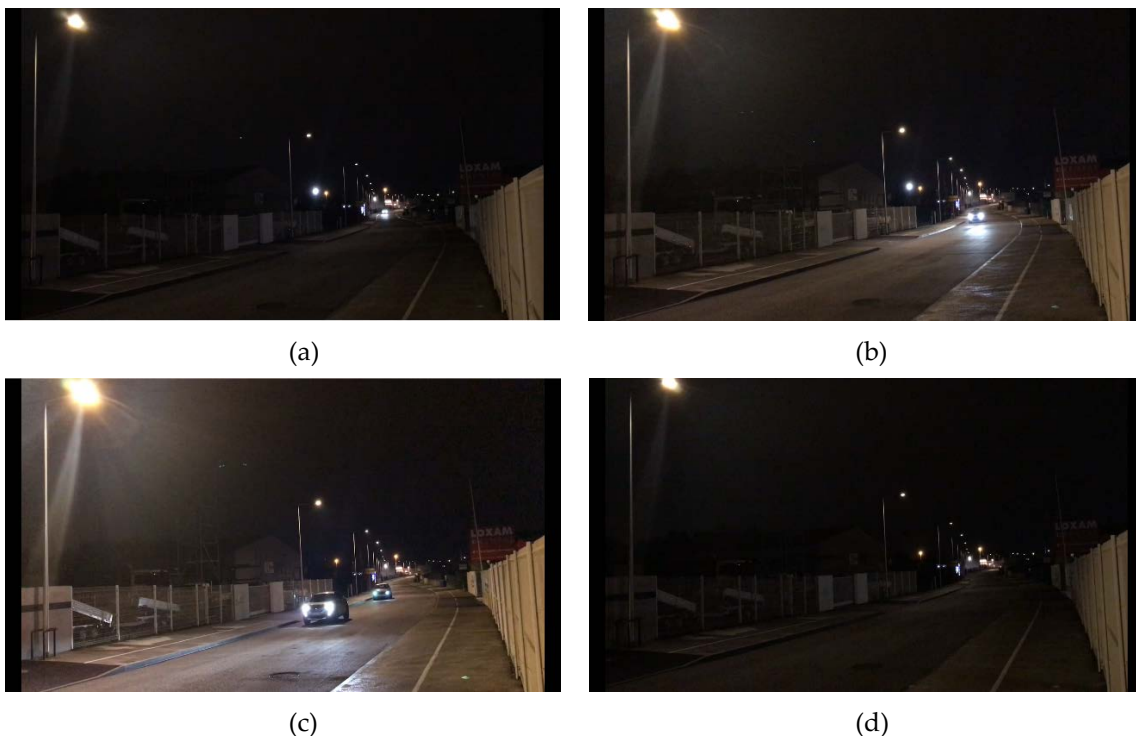
FIGURE 4. Fonctionnement du système d'éclairage intelligent au passage d'un véhicule (ordre chronologique : a, b, c et d).
