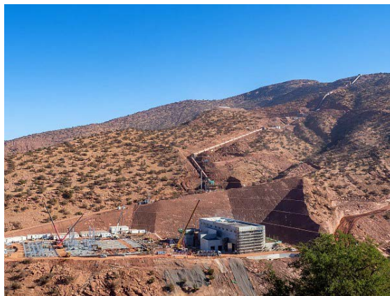
FIGURE 8. Station de Transfert d'Énergie par Pompage (STEP) d'Abdelmoumen – Maroc Conduite, turbines et pompes enterrée et sous station électrique
