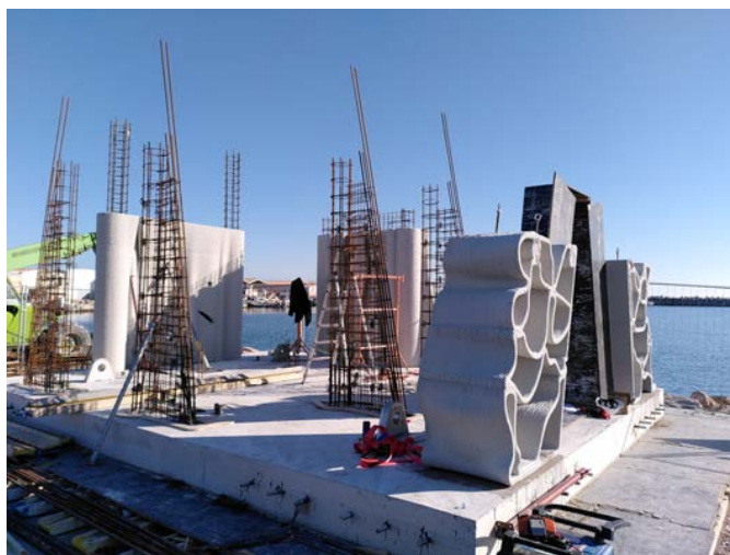
FIGURE 2. Photo de la réalisation d'une structure mixte avec en rouge les poteaux et poutres en béton armé coffrés par les éléments imprimés en 3D (RECIF LAB– 2021)
