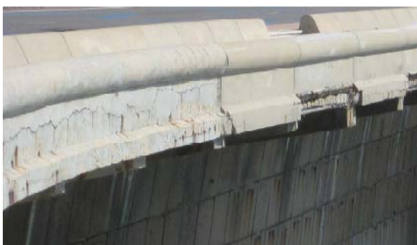
Figure 3 : Désordres observés sur un parapet et une dalle de l'ouvrage
