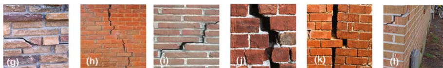
FIGURE 2. Exemples de fissures sur des structures en maçonnerie aisée [Dais et al. , 2021]
