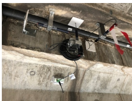
FIGURE 12. Instrumentation en place à la liaison ouvrage existant / ouvrage d'élargissement
