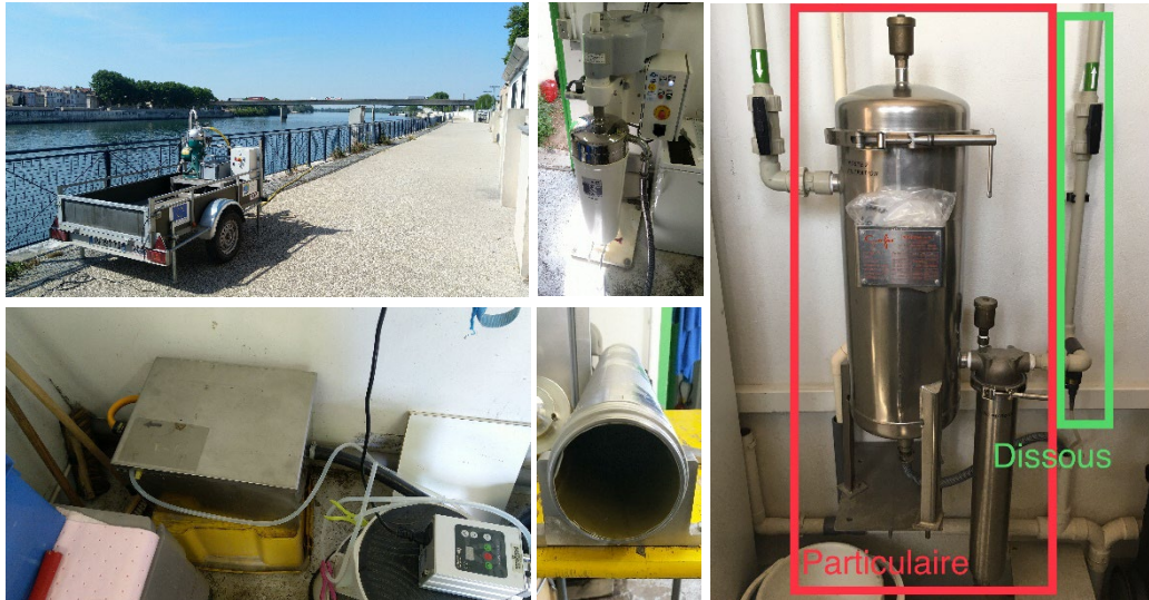
Figure 5 : Illustrations de la manip d'intercomparaison à Arles - mai 2022 (A : centrifugeuse mobile ; B : piège à particules ; C et D : centrifugeuse fixe ; E : cartouches filtrantes
