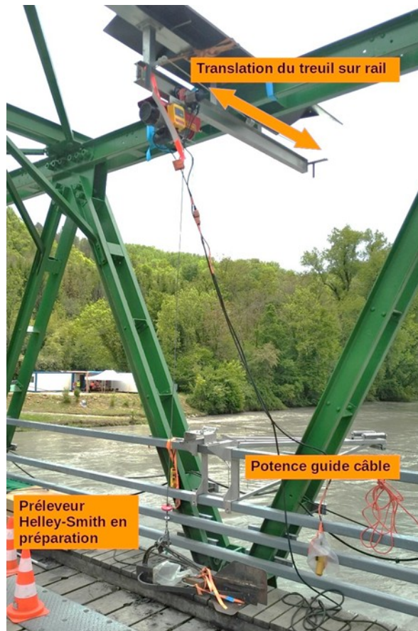
Figure 8: Dispositif de déploiement par treuil sur la verticale centrale du pont de Pyrimont.
