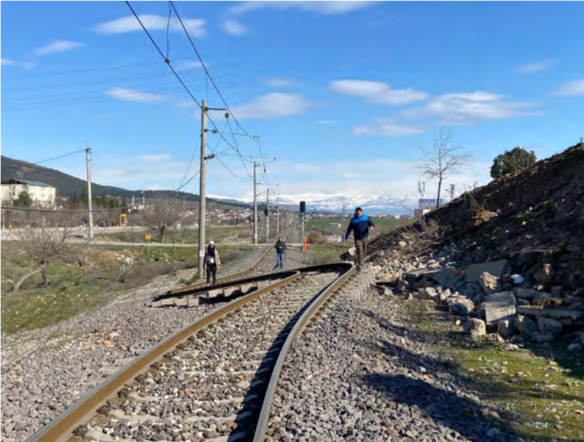
1 Déplacement latéral en surface déformant les rails à Şekeroba © Cengiz Zabcı
