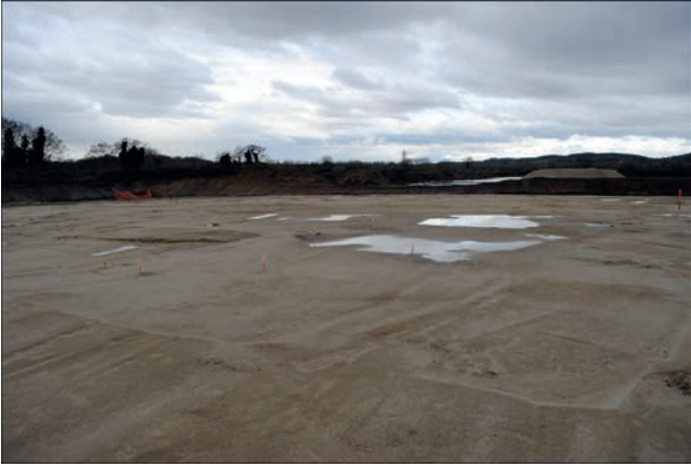
Vue générale du site à l'issue des intempéries du 06/03/2019
