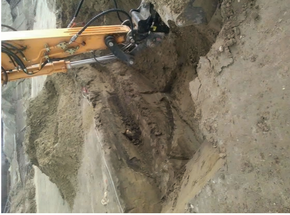
PN1423 : Vue générale de F1019 avant effondrement
