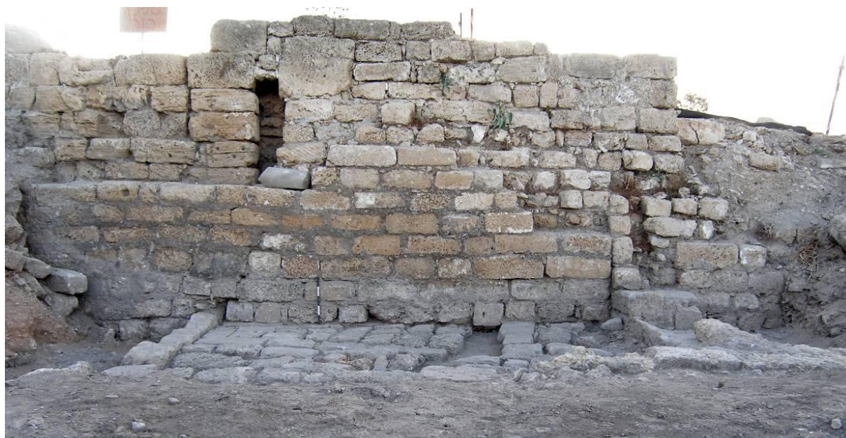
Figure 96 : Vue de la face Ouest de la tour, en 2009. Au premier plan, le dallage du bâtiment accolé aux ouvrages primitifs. Au-dessus, les six assises de l'épaississement. Au-dessus encore, sur la gauche, le parement de la pile M4, et sur la droite, séparé par un creux vertical, la maçonnerie bosniaque moderne.
