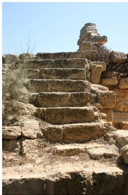
Figure 211 : Vue de l'escalier menant de la tour T14 au chemin de ronde de la courtine 13-14, prise depuis l'Ouest
