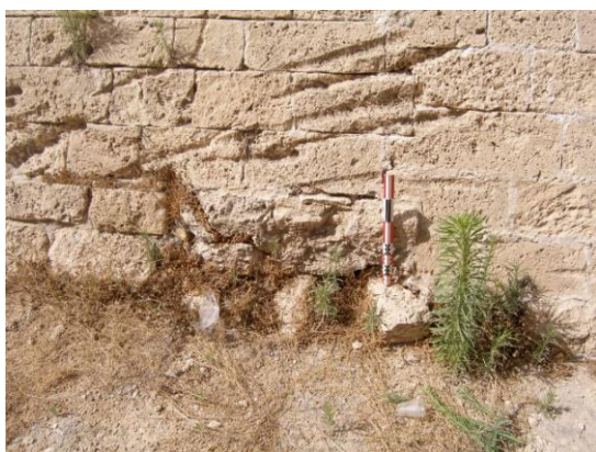
Figure 187 : Vue de l'arrachement du mur bas à l'Ouest de la poterne
