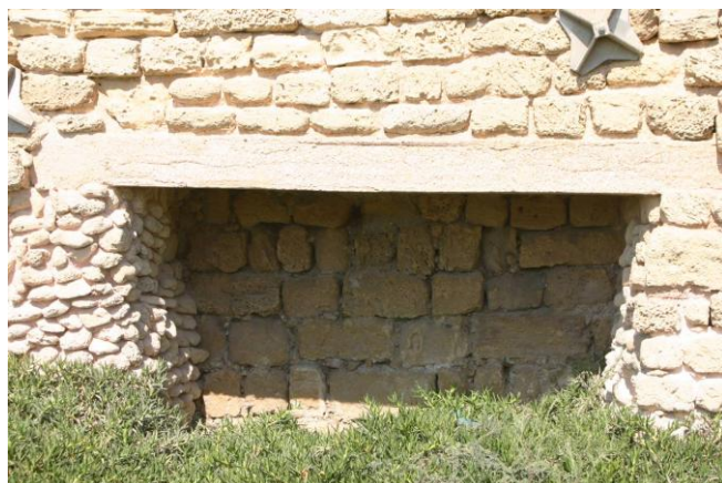
Figure 224 : Vue prise depuis le Sud du parement du mur primitif, laissé apparent après les fouilles des conduites de chasse du port Hérodien. Au-devant, élargissement Louis IX entièrement remonté autour de la fenêtre moderne.
