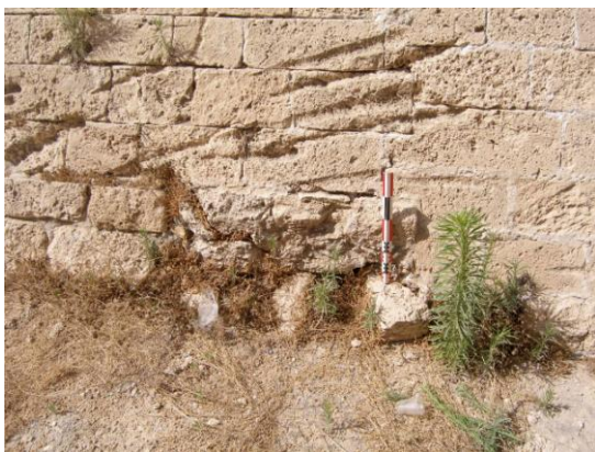
Figure 187 : Vue de l'arrachement du mur bas à l'Ouest de la poterne
