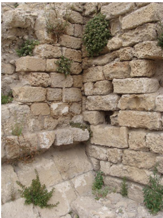
Figure 50 : Raccord entre le mur M24 (à droite) et le mur M10 (à gauche). On note la présence du glacis primitif (UM 3055), et au-dessus le mur construit sous Saint Louis, les deux étant collés contre M24 qui leur est antérieur.
