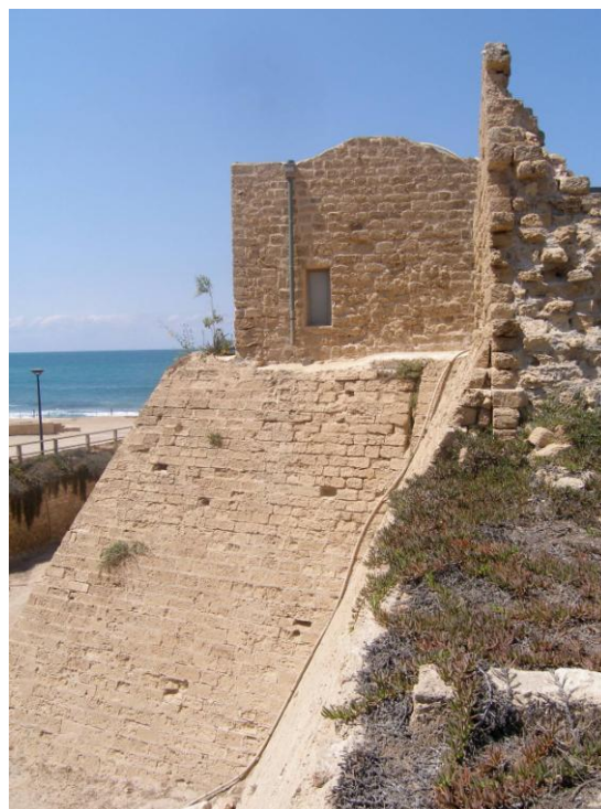
Figure 214 : Vue de la maison bosniaque sur la tour T14, et du glacis, prises depuis l'Est
