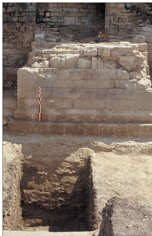
Photo 50 : vue de la tour de face avec ses fondations débordantes
