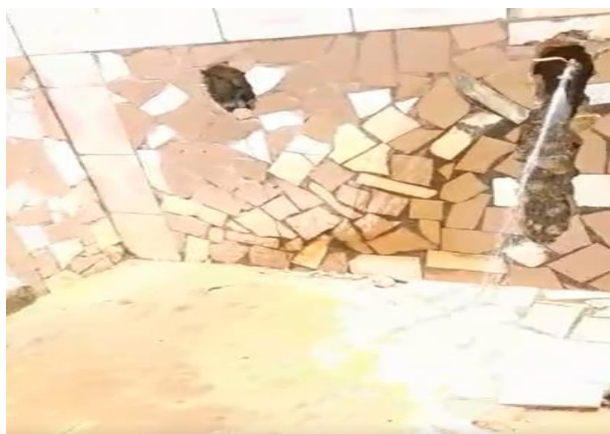
Photo 1: Des robinets ouverts et non refermés au lycée moderne d'Aboisso (crédit photo : Oussou, novembre 2021)
