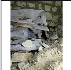
Photo 62 Détail parois effondrée de F4 - (Papin Pierre)
