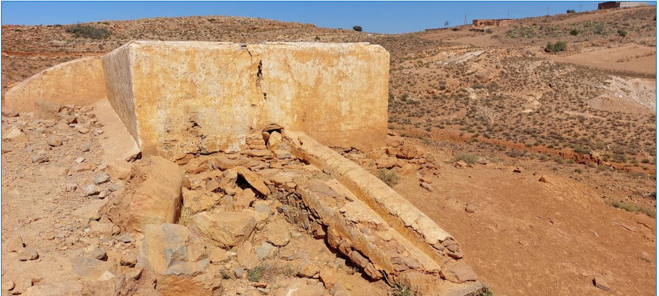
172 173 Fig. 4 : Exutoire d'une Noffia avec un canal maçonné pour éviter l'érosion en aval du réservoir [Anti-Atlas 174 occidental, Oct. 2021]
