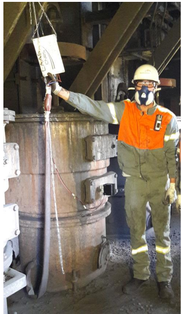
Fig. 13. Boîte à fumées (BAF) instrumentée. L'électronique est déportée en haut à gauche dans la boîte métallique claire, dans une zone moins chaude. La prise de mesure est en bas à gauche du cylindre les fils du capteurs sont dans une gaine protectrice.
