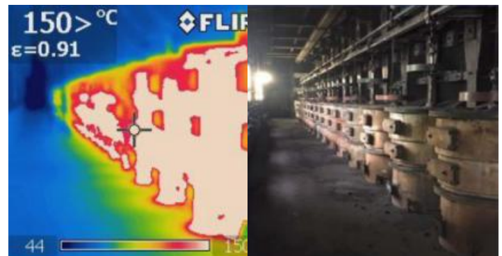
Fig. 1. Images thermique et dans le visible d'une batterie de BAF.
