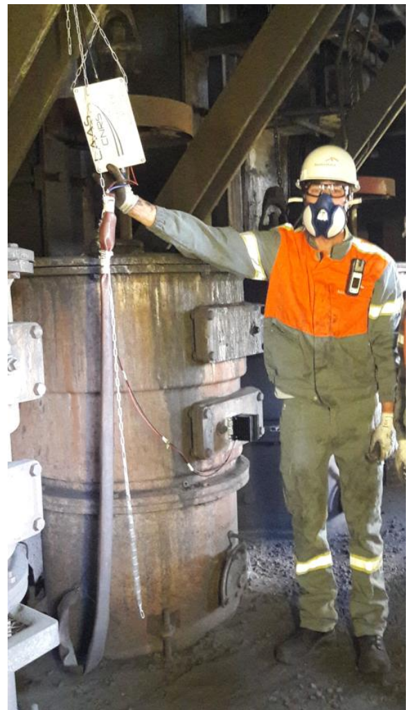
Fig. 13. Boîte à fumées (BAF) instrumentée. L'électronique est déportée en haut à gauche dans la boîte métallique claire, dans une zone moins chaude. La prise de mesure est en bas à gauche du cylindre les fils du capteurs sont dans une gaine protectrice.
