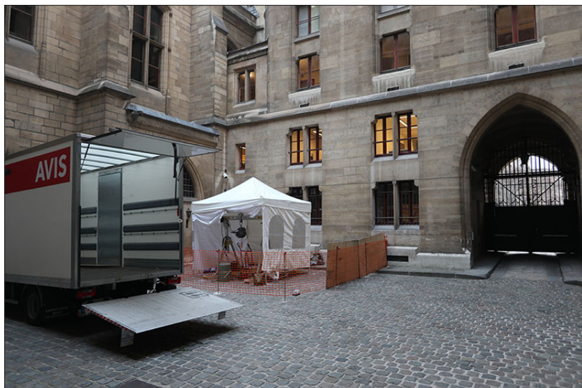
Fig. 5. Vue de l'installation de surface du puits blindé dans la cour de la Conciergerie. Cliché : David Couturier, DHAAP.
