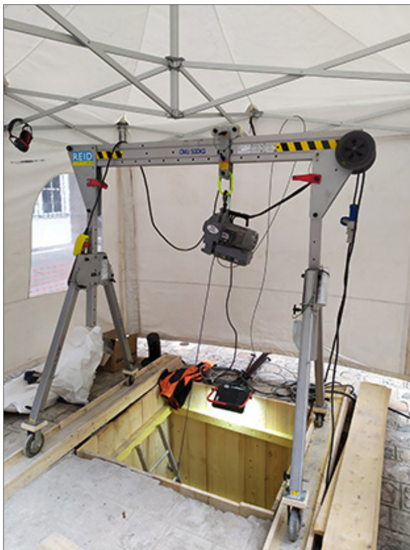
Fig. 6. Vue de l'installation de surface du puits blindé SD 4. Cliché : David Couturier, DHAAP.
