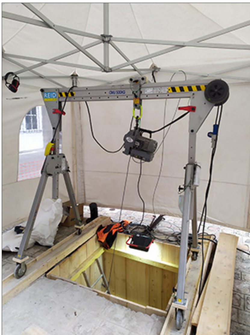
Fig. 6. Vue de l'installation de surface du puits blindé SD 4. Cliché : David Couturier, DHAAP.
