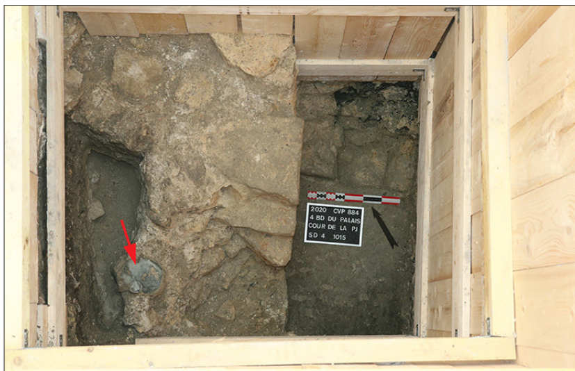
Fig. 24. Les murs 1007 et 1014 et le sol 1015 (sous l'ardoise). À noter l'injection guidée de ciment (flèche rouge) et ses effets sur les couches archéologiques (cf. angle nord-est du sondage). Cliché : David Couturier, DHAAP.
