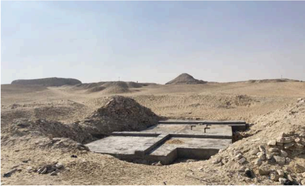
Fig. 19. Vue du caveau et du serdab après la construction du toit (MafS, C. Alvarez).
